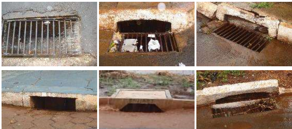
Figura 111: Tipos de bocas de lobo existentes na área urbana de Centralina
