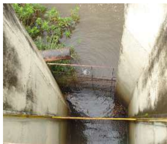
b) Tomada de água do rio Piedade, com destaque para o gradeamento inicial
