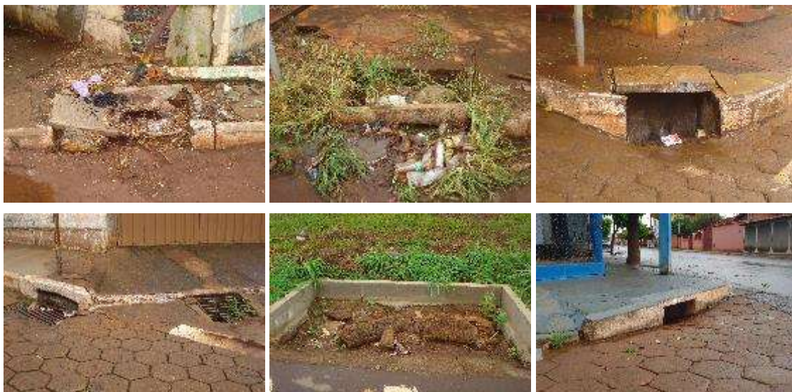
Figura 113: Problemas estruturais e de posicionamento em diversas bocas de lobo
