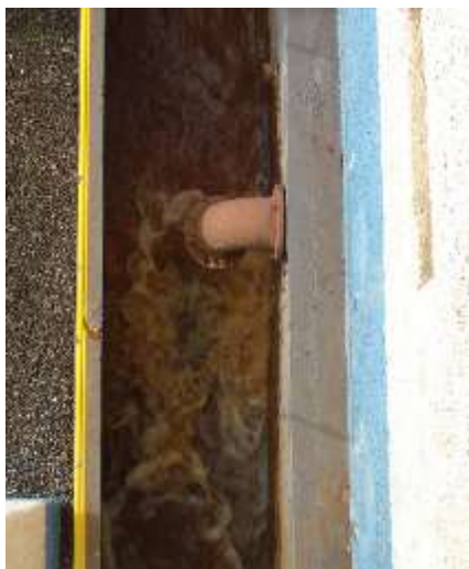
(g) Canal coletor de água de lavagem dos filtros.
