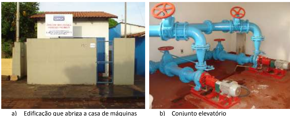
Figura 92: Instalações do booster que compõe o sistema de distribuição de água de Centralina
