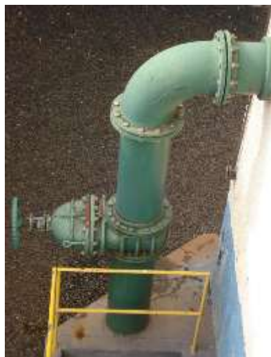
(h) Conduto coletor de água filtrada.
