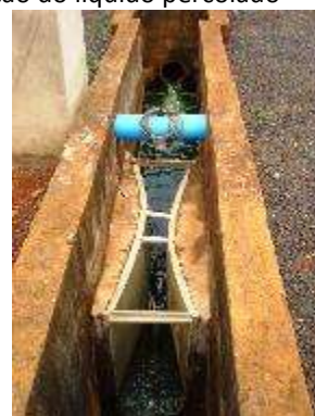
Medidor de vazão tipo calha Parshall
