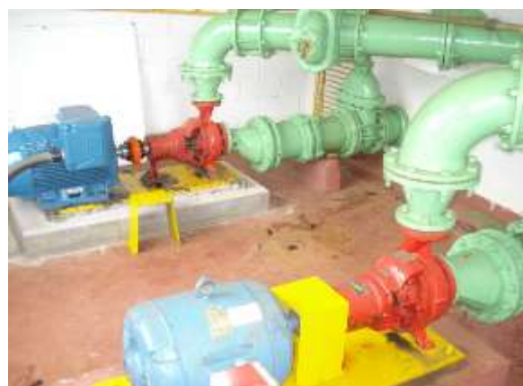
b) Conjuntos moto-bomba da estação elevatória (EEAB).
