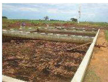
Leitos de secagem do lodo
