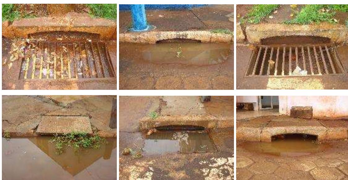
Figura 112: Problemas de entupimento de bocas de lobo na área urbana de Centralina
