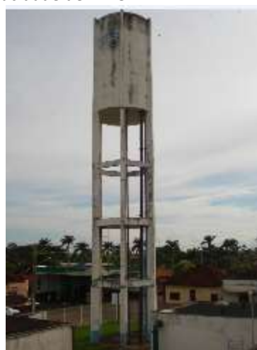
(c) Reservatório elevado 3 (150 m 3 )
