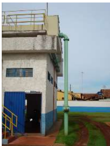
Figura 85: Segmento final da adutora de água bruta do sistema Piedade
