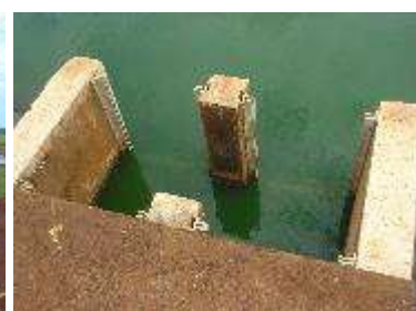
Comporta na saída da lagoa facultativa
