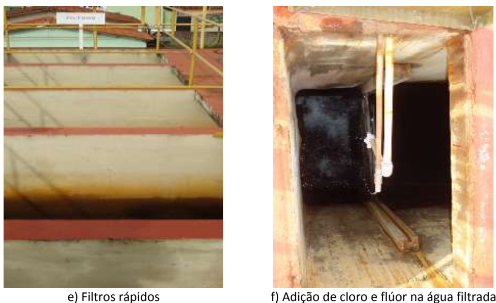
Figura 87: Decantadores e filtros da ETA, fev. /2015
