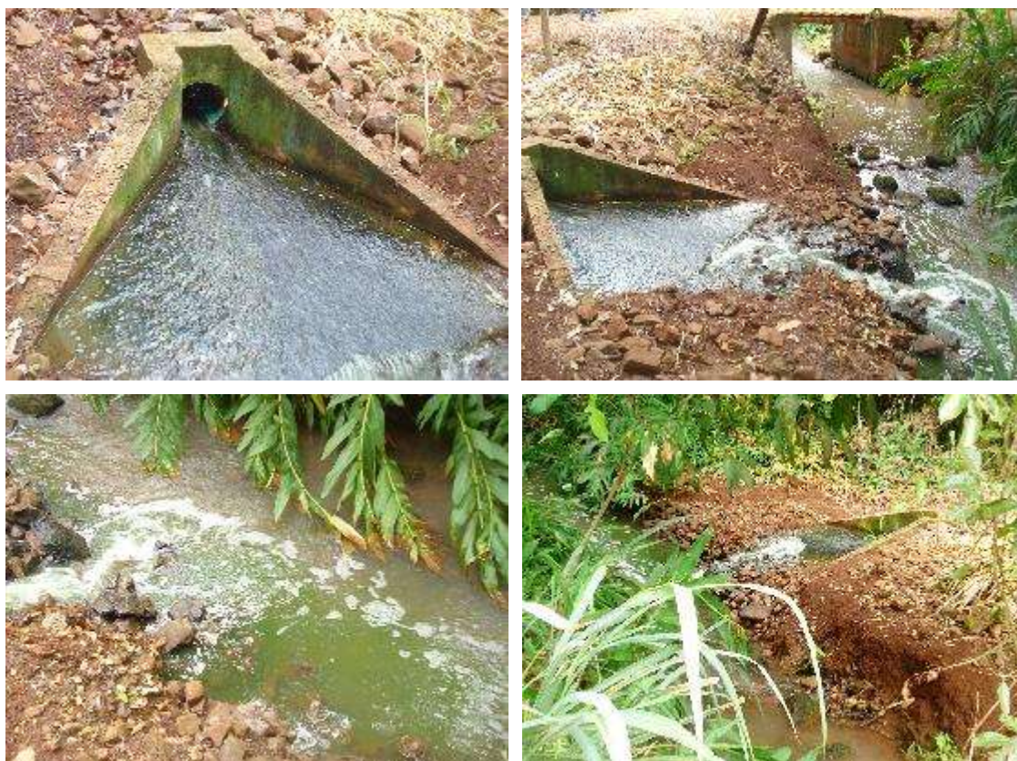
Figura 105: Local de lançamento do esgoto tratado no córrego da Lagoa
