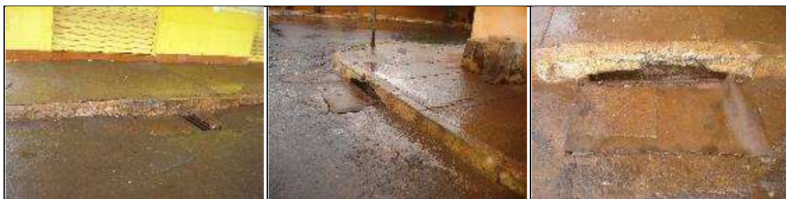
Figura 119: Vedação de algumas bocas de lobo na região central de Centralina
