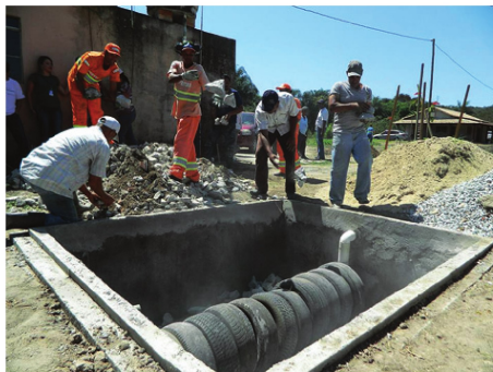
Imagem 14: Tubo de entrada do efluente posicionado para dentro da câmara anaeróbia
