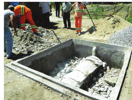
Imagem 4: Tubo de entrada do esgoto
